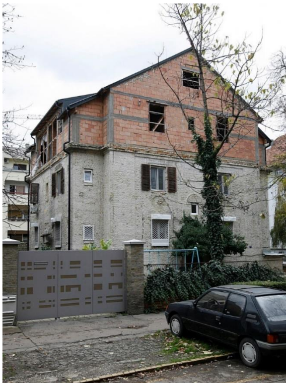
Постојеће стање, након неадекватне надоградње
